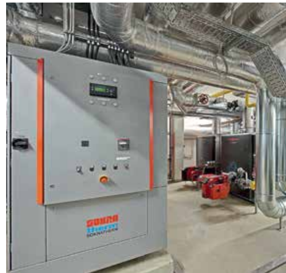
Die Energiezentrale des Ballhausforums versorgt gleichzeitig die später ergänzten Hotelkomplexe.
