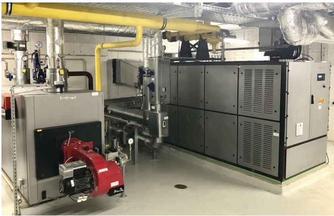
Die Energieerzeugungs-Zentrale: Gas-Brennwertkessel (links) und Gas-BHKW (rechts)
