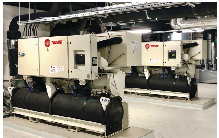
Schraubenverdichter-Kältemaschinen in der Energieerzeugungs-Zentrale
