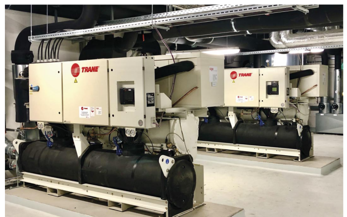
Schraubenverdichter-Kältemaschinen in der Energieerzeugung-Zentrale
