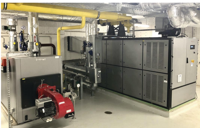
Die Energieerzeugung-Zentrale: Gas-Brennwertkessel (links) und Gas-BHKW (rechts)
