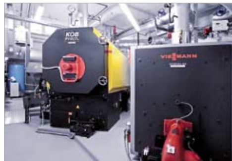
Heizzentrale Wohnanlage CvL, Unterschleißheim
